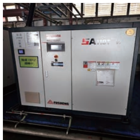
150HP 空壓機汰換
