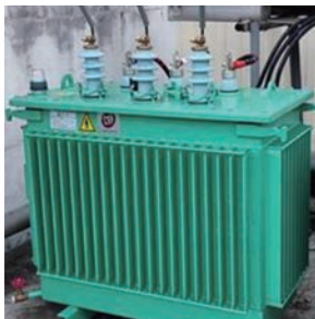
導入 200KVA 士林省能源環保型高效能變壓器
